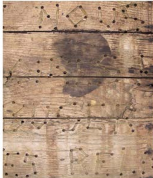
RELEVÉ DES ALTÉRATIONS CONSTATÉES PAR LE RESTAURATEUR AU PRINTEMPS 2023
